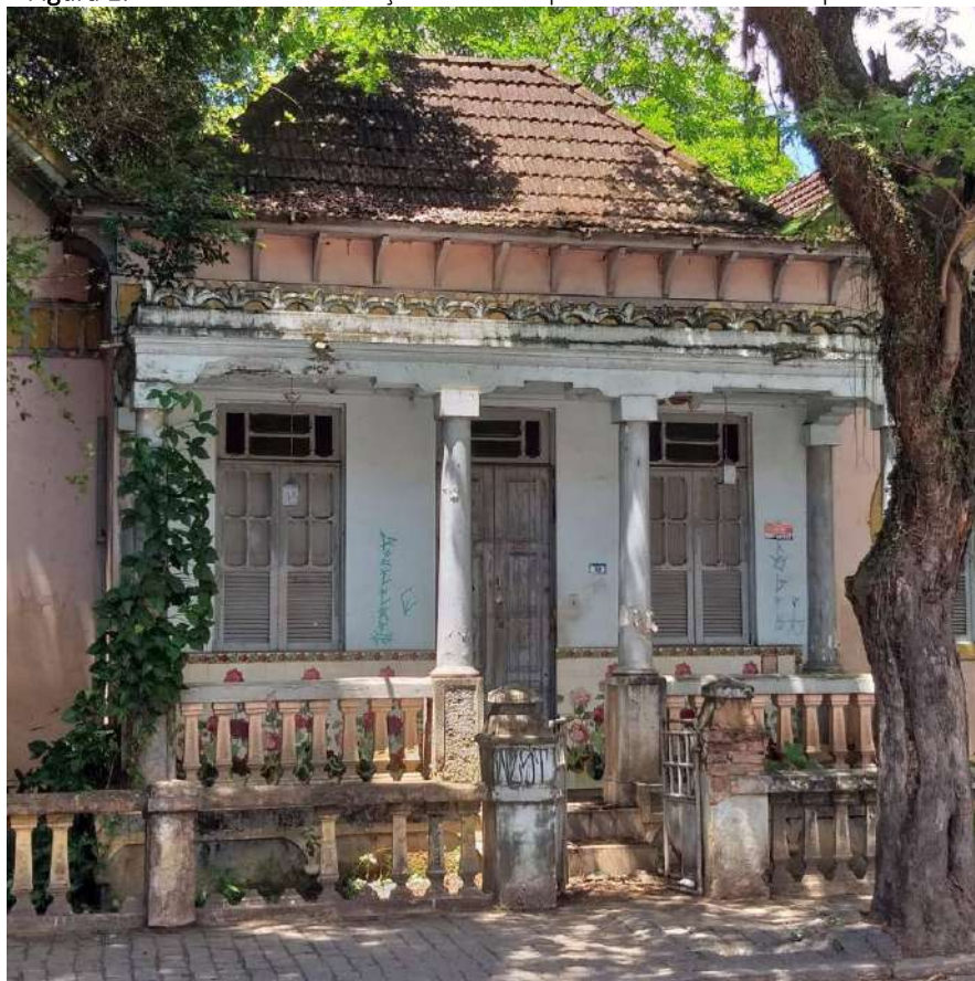
Figura 1. Casario em deterioração no município de Cachoeiro de Itapemirim-ES.
