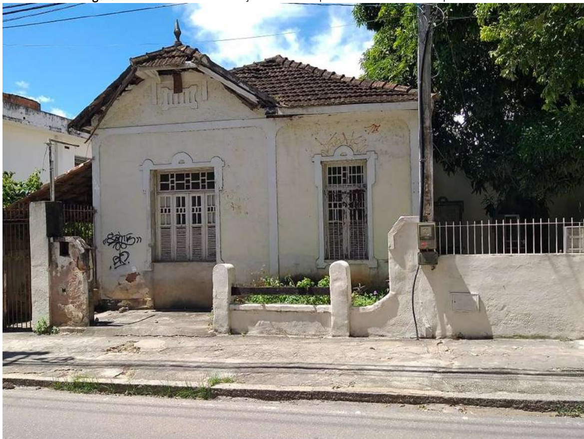
Figura 2. Casario em deterioração no município de Cachoeiro de Itapemirim-ES.
